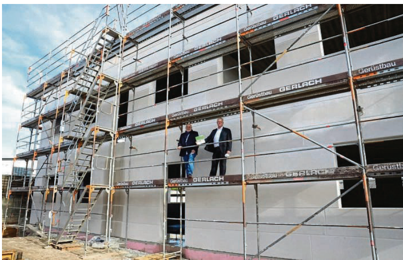
Zum „grünen“ Neubau passt auch das Energiekonzept, das CeoTronics-Chef Thomas H. Günther (rechts) und Projektmanager Peter Herdt (Herdt Consult, Ober-Roden) an der frischen Luft präsentierten: Eine Photovoltaik-Anlage erzeugt pro Jahr fast 30 000 Kilowattstunden Strom, die mit einer Batterie gespeichert werden können. FOTOS: LÖW
